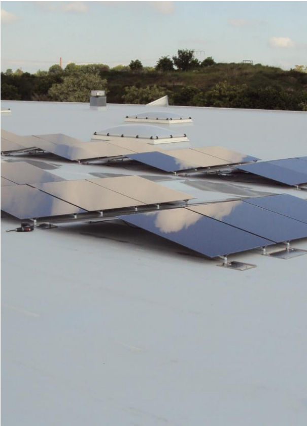
Foto 3.2. (Solarelemente auf dem Flachdach)
